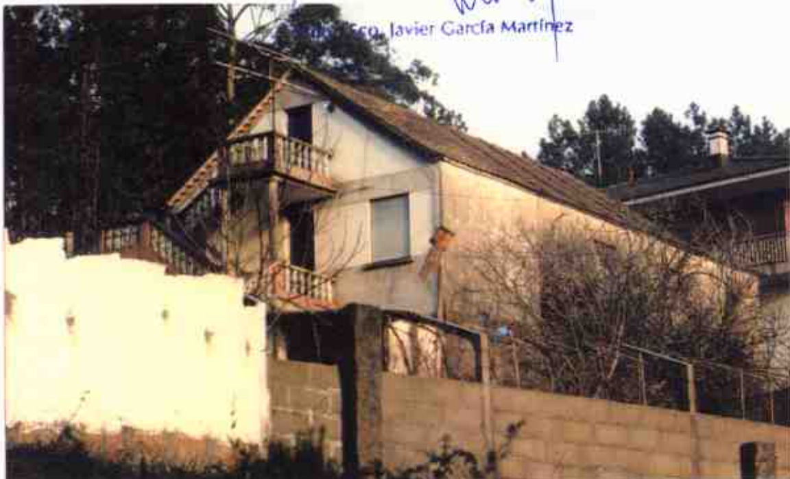
17 O DETERIORO DO NÚCLEO : Edificación no ano 1991
